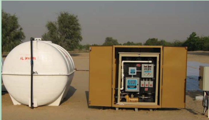
وحدة معالجة المياه المالحة في محطة البحوث الزراعية للمركز
