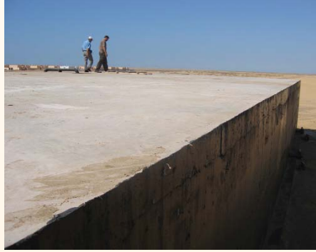
خزان حفظ المياه في موقع المشروع
